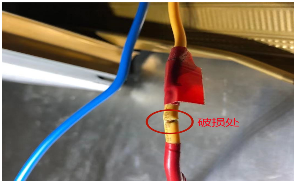
图 2：黄色火线破损处
