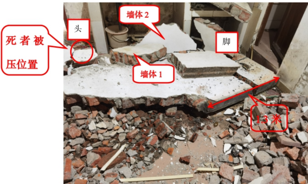
图 3-2：“7”字型内隔墙倒塌后现场情况
